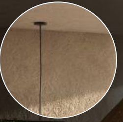
REVESTIMIENTO Pintura texturizada
